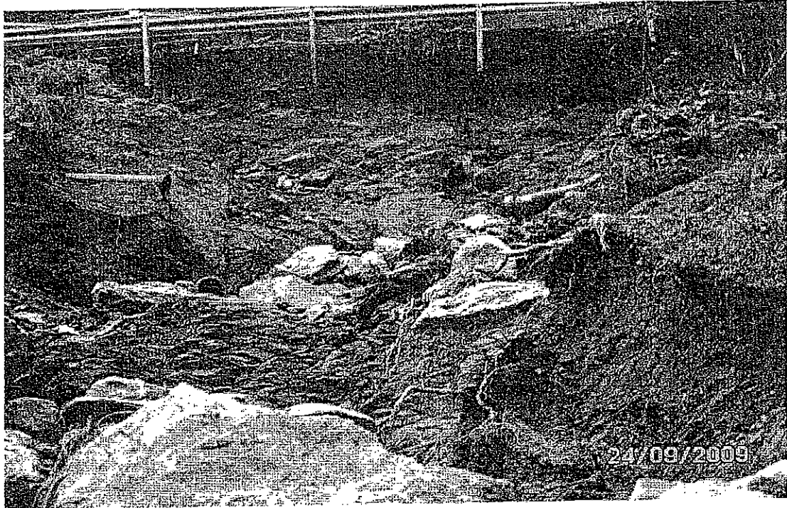
Contrada Lenzina - sottoservizi distrutti dalla frana
